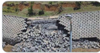
붕괴 위험(옹벽, 축대 등)
